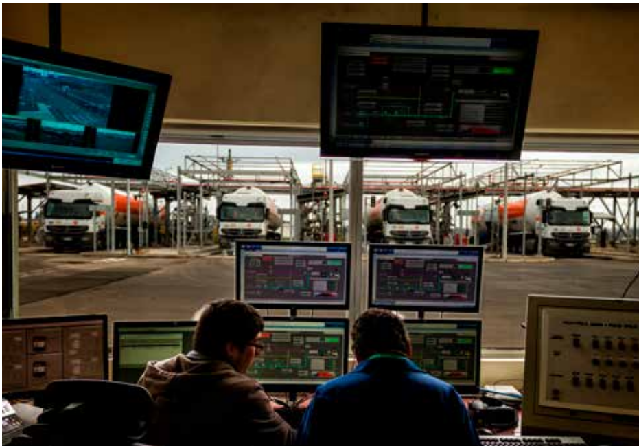
> Sala de control para carga de cisternas en GNL Quintero (Chile).
